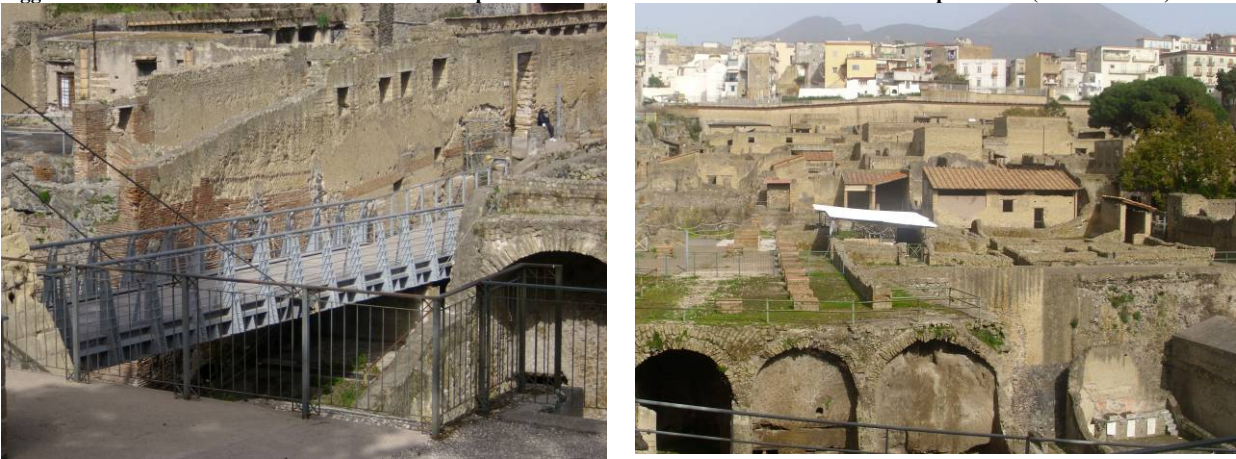
Figg. 55 e 56 - Area Scavi di Ercolano: sistemazione ponte di attraversamento e messa in sicurezza scarpata nord (fonte: NVVIP)
