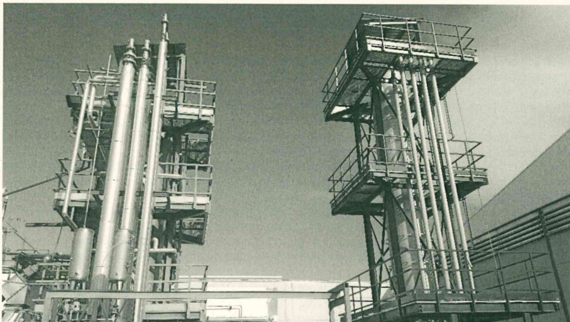
Impianto pilota Ingelia in Naquera
